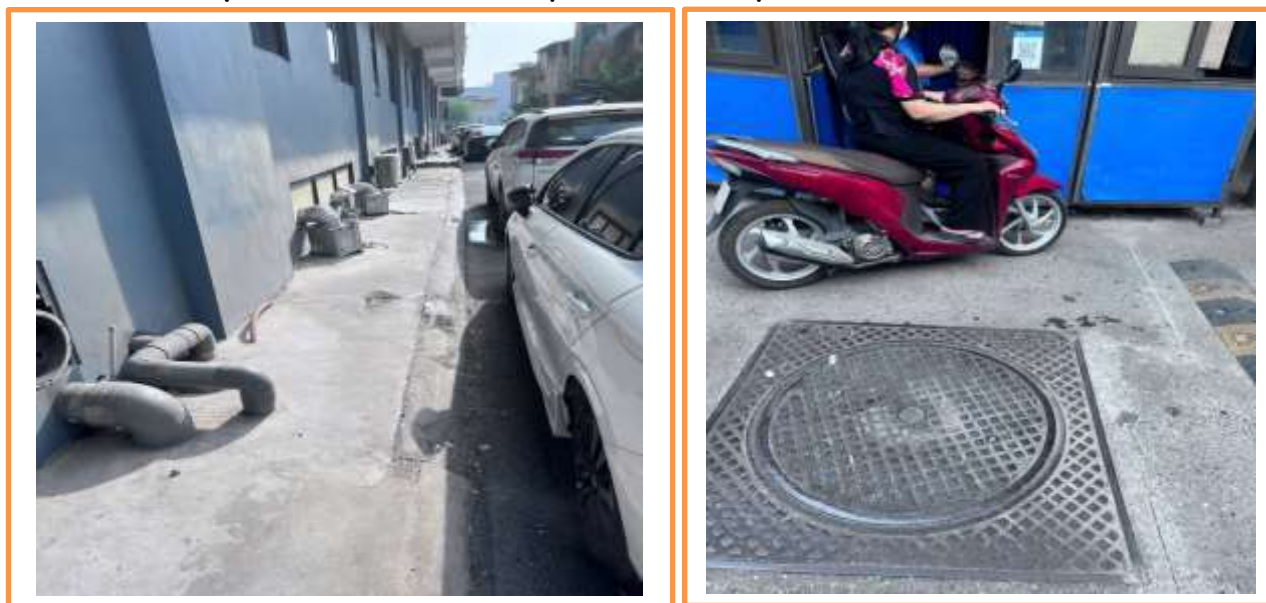
Hình 3. 2. Cống thoát nước mưa và vị trí cửa xả nước mưa số 2
